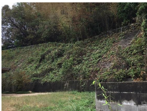
急傾斜地危険区域（看板設置あり）
